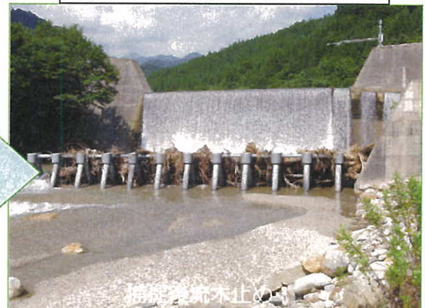
H16.7豪雨出水後堆砂状況
