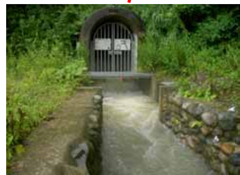
H17.7豪雨時 排水トンネル工
