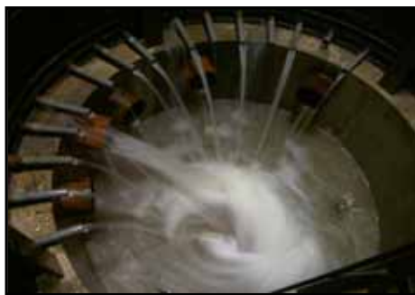
H17.7豪雨時 集水井工 内部
