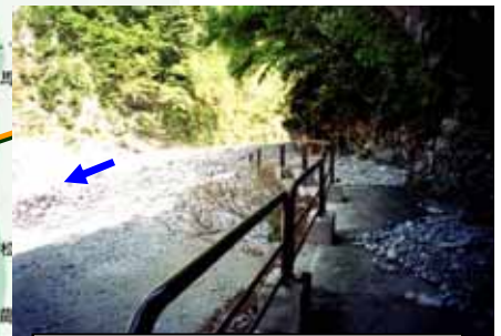
土砂で埋没した猿飛峡遊歩道
