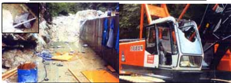
平成15年度発生 of えん堤施工箇所への落石被災
