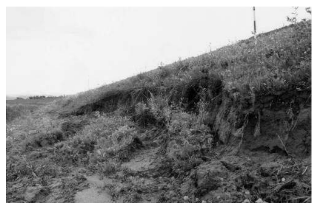
堤防の浸透対策（法崩れ） （平成14年7月出水）
