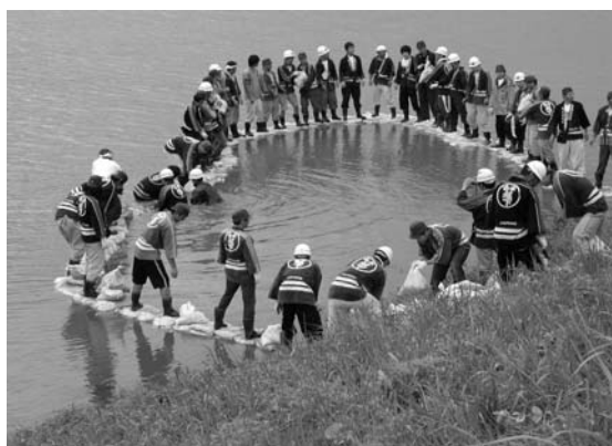
堤防の浸透対策（漏水対策） （平成14年7月出水）
