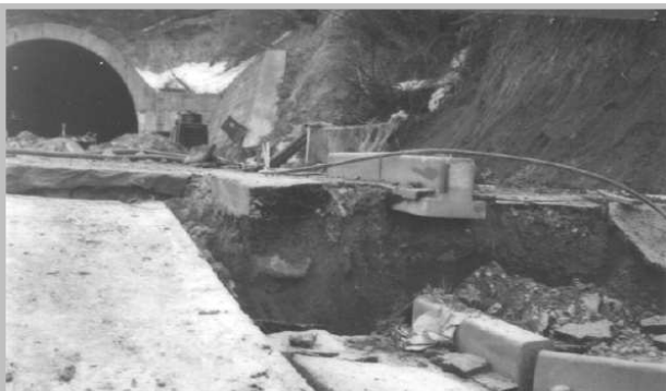
[S59. 4. 23] 片貝トンネル新潟坑口付近・地すべり(84日間通行規制)
