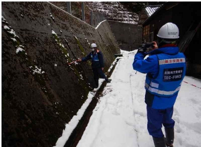
施設の被災状況調査(当日 尻田谷内)
