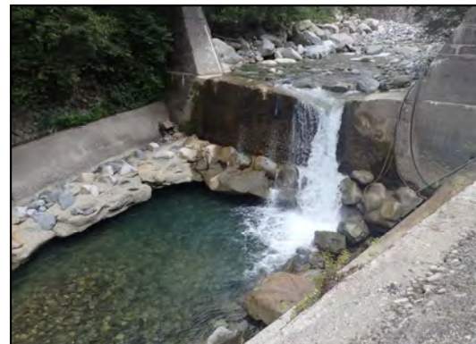
水通し部の摩耗及び水叩き工の欠損
