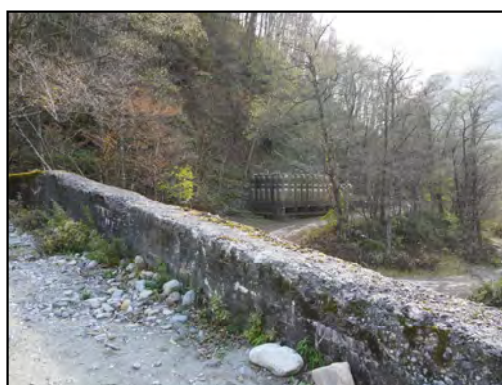
袖部の劣化状況
