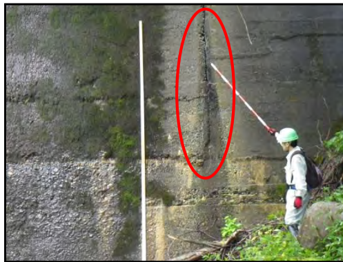
本堰堤の目地損傷状況
