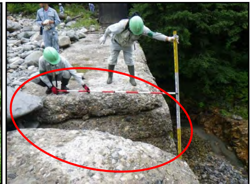
本堰堤の水通し損傷状況
