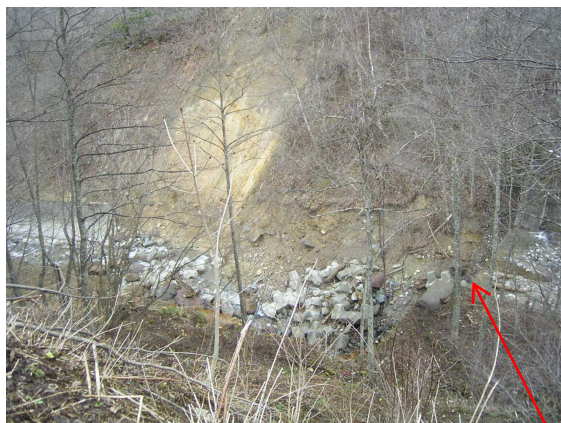
異形ブロックの散乱・右岸法面の滑り
