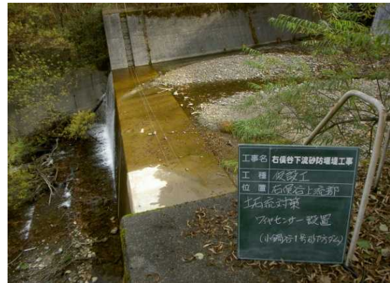
小鍋谷砂防堰堤ワイヤーセンサー設置状況
