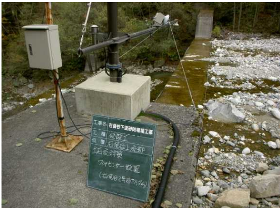
右俣谷2号砂防堰堤ワイヤーセンサー設置状況
