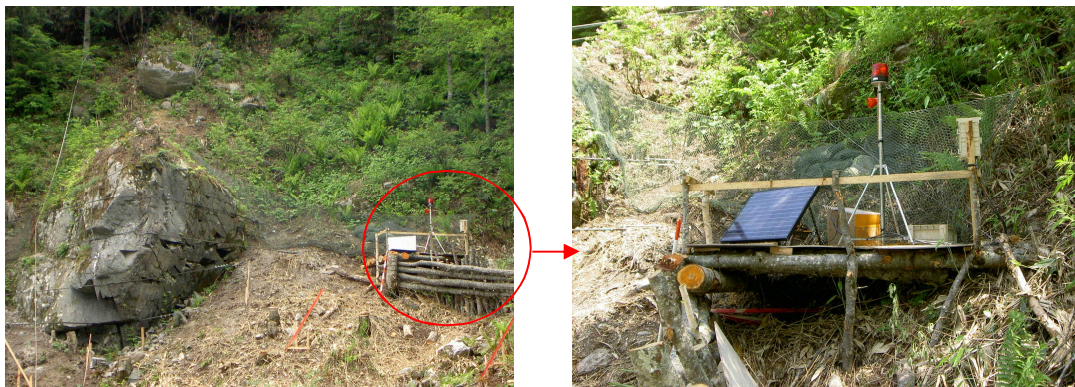
警報システム設置状況
