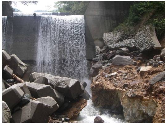
副えん堤底部約 5m 洗掘(外ヶ谷 6 号)
