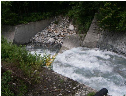
床固工側壁流失（右俣谷）
