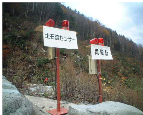
(現場内のセンサー表示)
