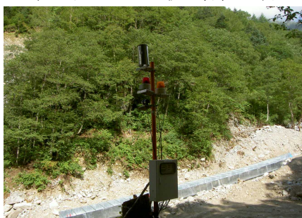
写真3 警報装置付雨量計
