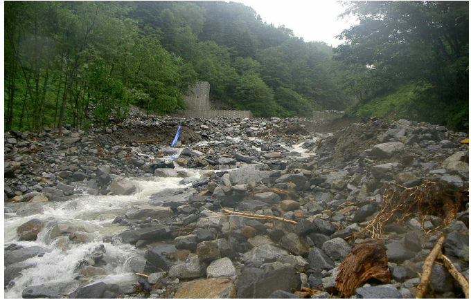
写真14 仮設道路被災後(18日10時撮影)
