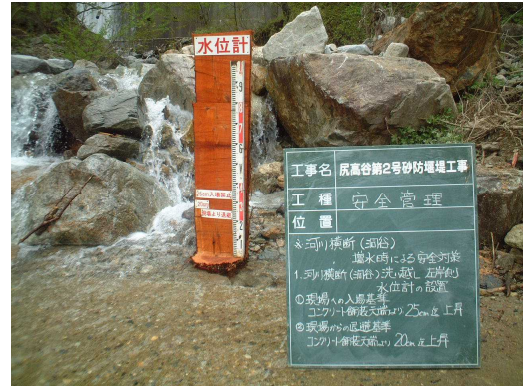
水位計設置状況
