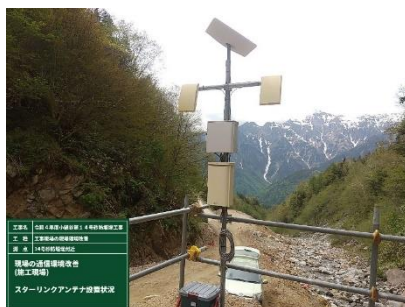
現場用スターリンク設置状況
