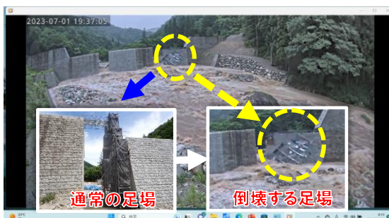
【写真-8 カメラが撮った濁流により足場倒壊】
