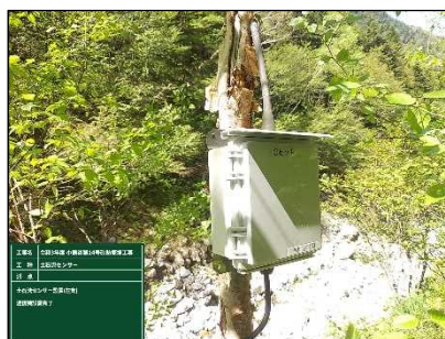
送信器設置状況
