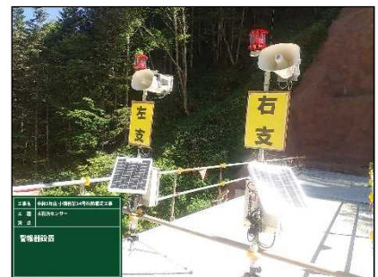
警報機設置状況
