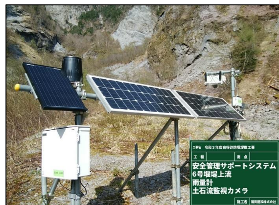
【写真-5 現場上流 雨量計・土石流監視カメラ】
