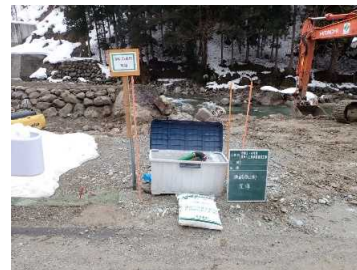
凍結防止材の配備
