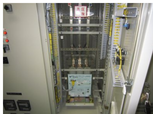
【発電機切替盤】
