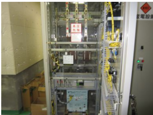
【高圧引込受電盤】
