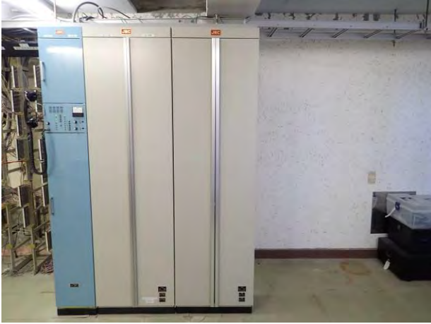
【写真1 テレメータ中継装置】
