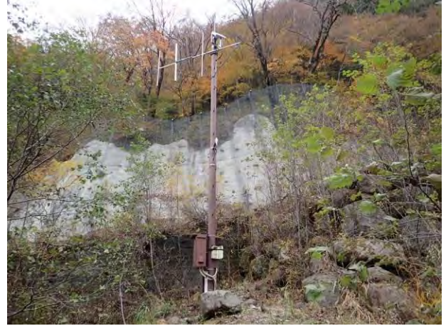
【写真2 テレメータ設備】
