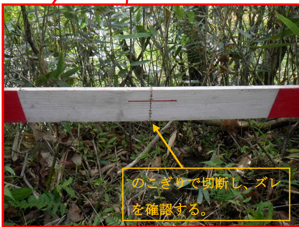
斜面の変動確認【写真－7】
