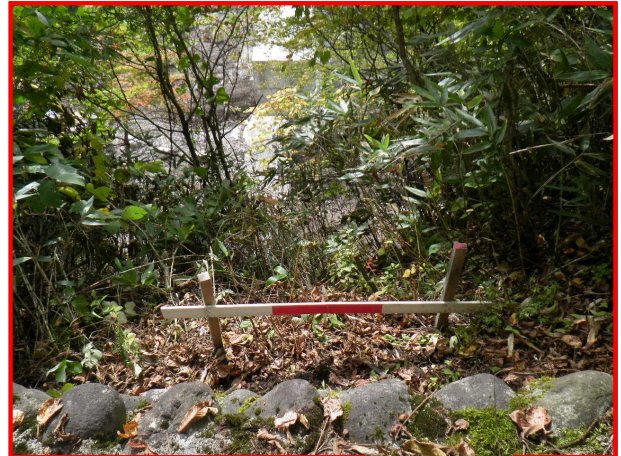
斜面の変動確認【写真－6】
