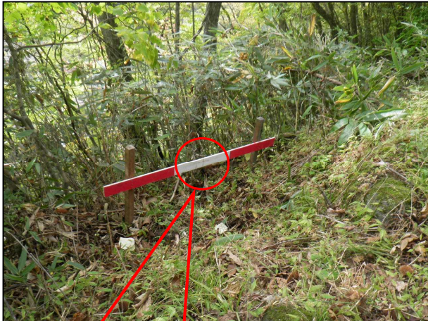
斜面の変動確認【写真－5】
