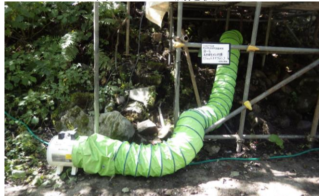
図 4.9 送風機設置状況
