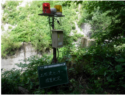
外ヶ谷第7号警報装置
