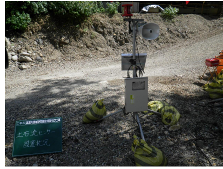
外ヶ谷第9号警報装置
