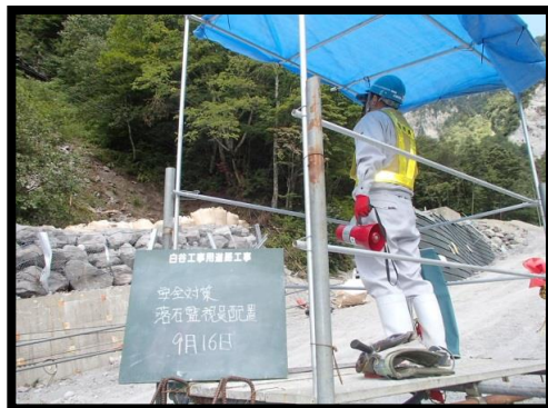
(落石監視員配置)
