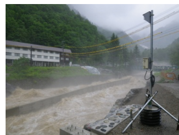
監視カメラ設置
