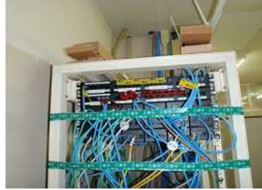
写真2. 機器と配線の識別標示状況
