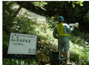
〔写真-5 落石監視員の配置〕
