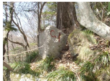
〔写真-2 斜面浮石状況〕
