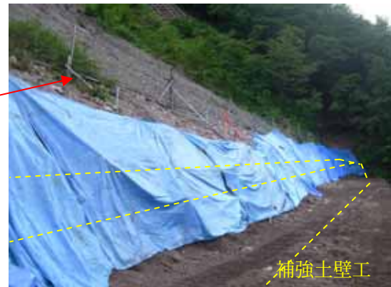
【ブルーシート・落石防護柵】
