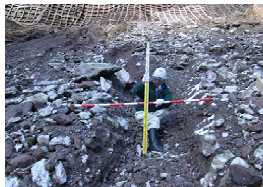
【施工法面上のガリ侵食】
