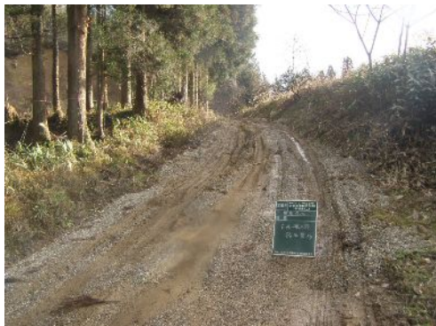
搬入路修繕前
