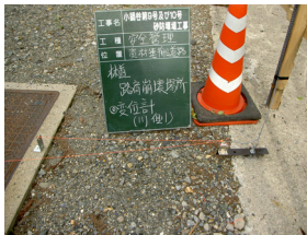
変位計（崩壊側）
