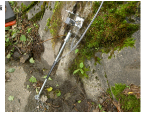
変位計（ブロック積側）
