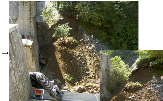
崩壊直後(H22. 9. 27午前)、崩壊土量 約50m 3
