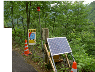
現場（上流）側回転灯他
