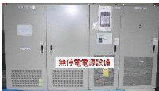
蓄電池盤 UPS盤入出力盤
