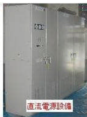
整流器盤 蓄電池盤
