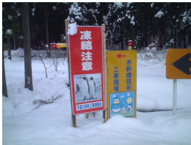
凍結注意看板設置
