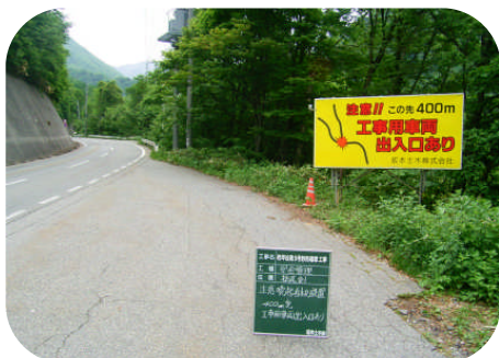
一般車に対する注意喚起看板 (幅3.6m×高さ1.8m)
