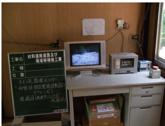
現場事務所内の監視システム
