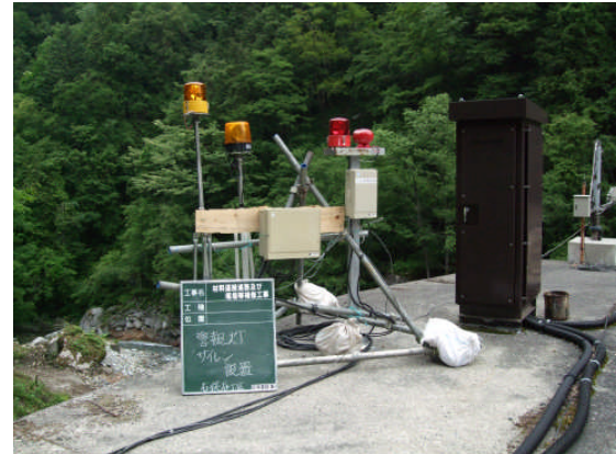
現場内のセンサー表示
