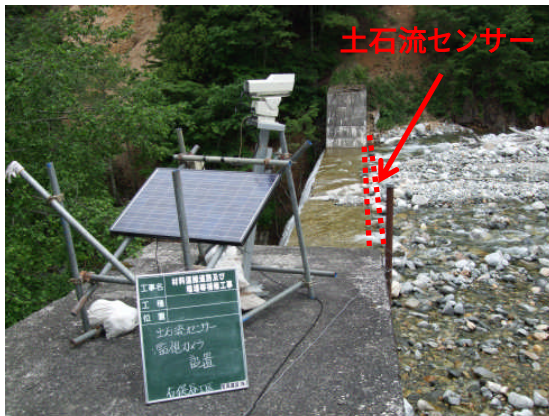
土石流センサー及び監視カメラ
