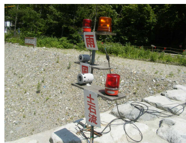
4.土石流・雨量・風力用回転灯、サイロ（左岸本堤天端）
