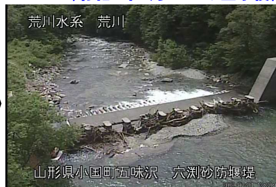
R4.7.1 (令和4年6月27日の出水後)
