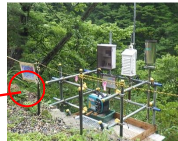
発々の排気口の向きを変更その後居なくなりました。
