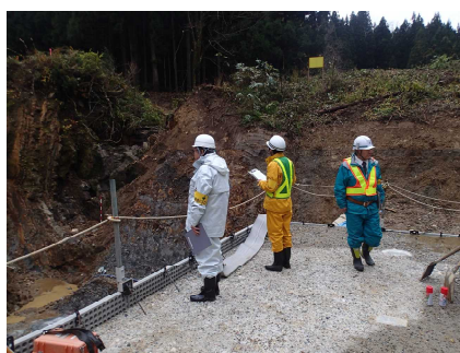
戸沢川砂防堰堤 （ロープの緩み）
