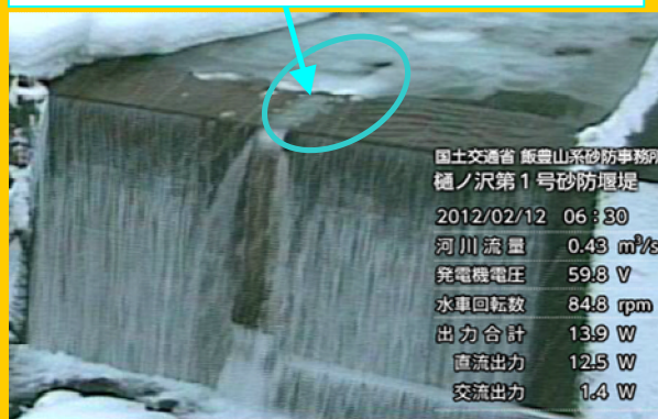
上流より流れてきた雪塊により導水が阻害され発電量が低下している時の様子。
