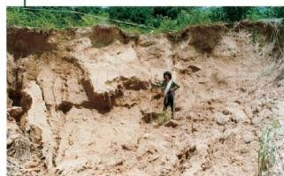
豪雨による土砂流出(加治川流域姫田川)
