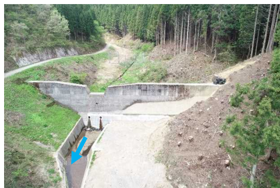
被災前の状況 (撮影:R4年6月)
