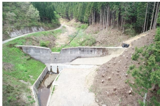
被災前の状況 (撮影：R4年6月)
