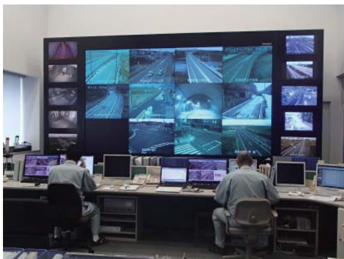
①情報管理室の大型モニターと管理業務の状況
