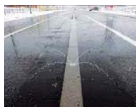
④散水状況
