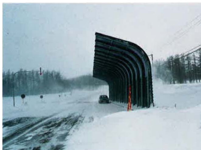
②片屋根式の鋼製シェルター
