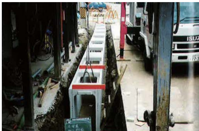
④流雪溝設置状況
