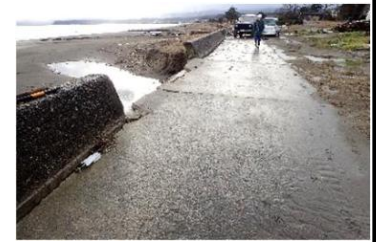
津波による海岸護岸の被災
