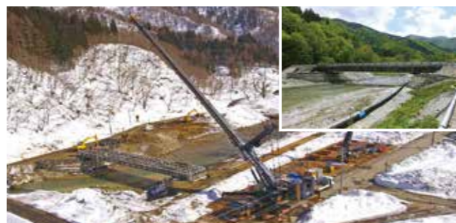
迂回路を確保するため応急組立橋を架設しライフラインを確保
