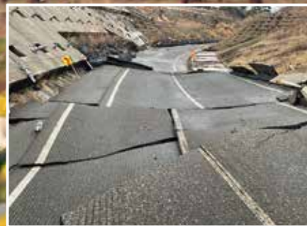
被災状況(国道249号珠洲市馬縷町)
