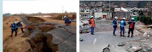
被災した河川堤防や道路の現況調査
