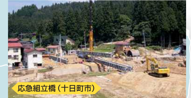
被災後の六箇橋
